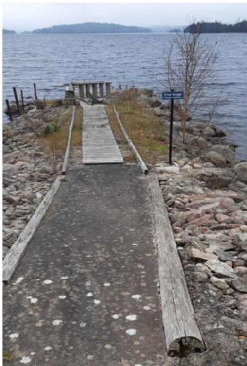
Bild 8. Piren sedd från land. Ca 5 m långt och knappt 1 m brett betongblock, följt av en ca 15 m långt trädäck, där de sista ca 4 m har en betongplatta och kraftiga järnbalkar som fundament.
